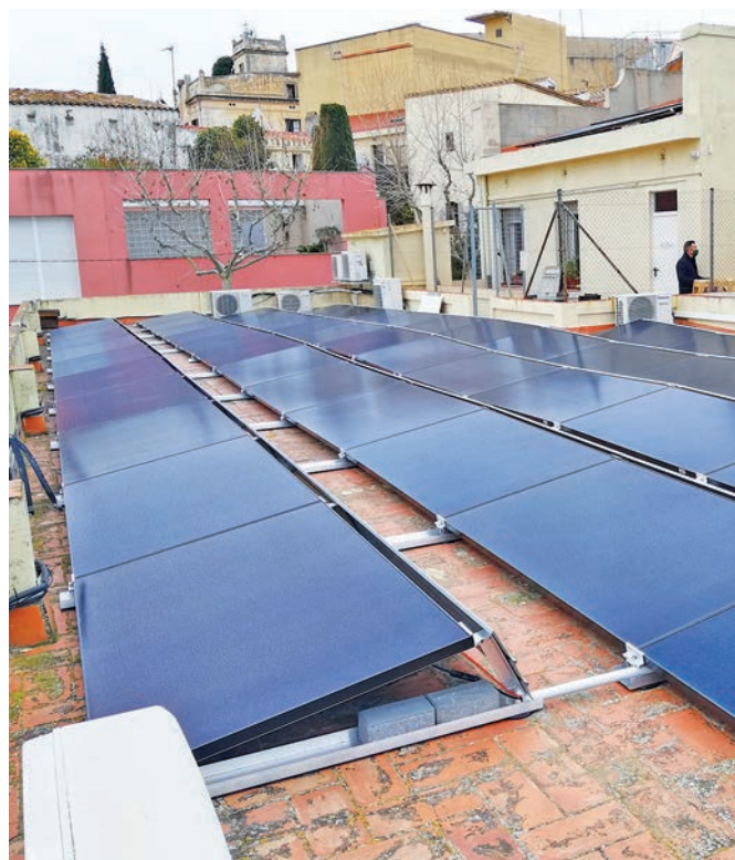
A l'Ajuntament ja hi ha 98 plaques solars instal·lades. AJ TIANA
